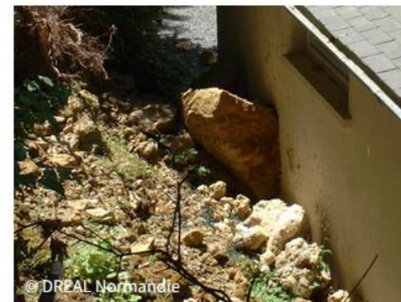
Chute de blocs à Trouville-sur-Mer (14)
