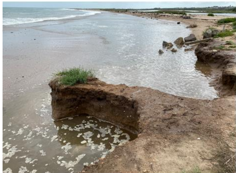
Erosion d'une côte meuble à Vicq-sur-Mer (50)
